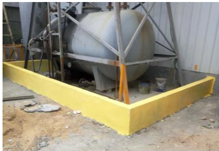
图 2-4 导热油炉围堰
