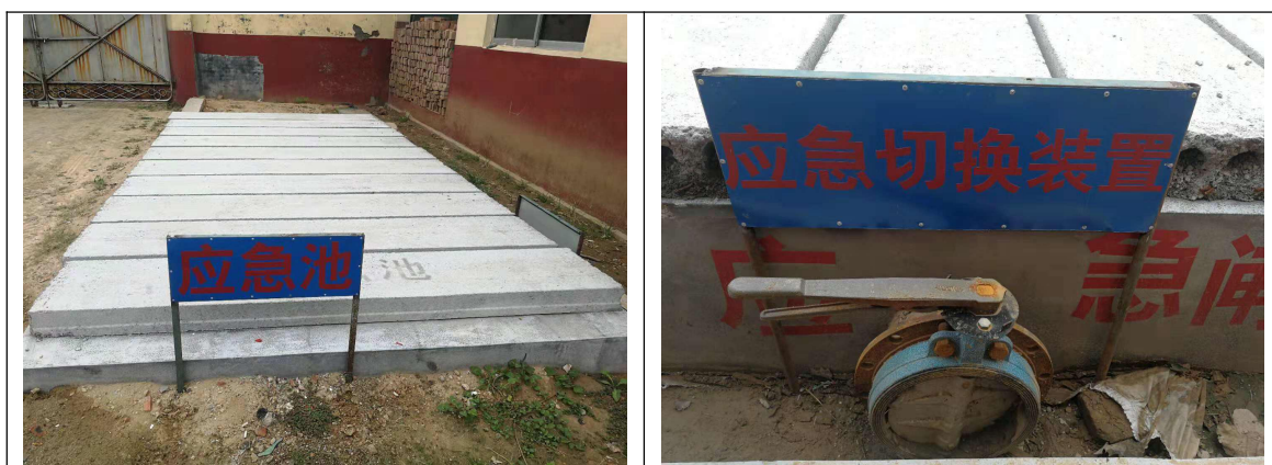
图 2-4 事故应急池及切换装置
