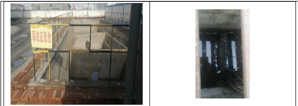
图 2-3 事故应急池及切换装置
