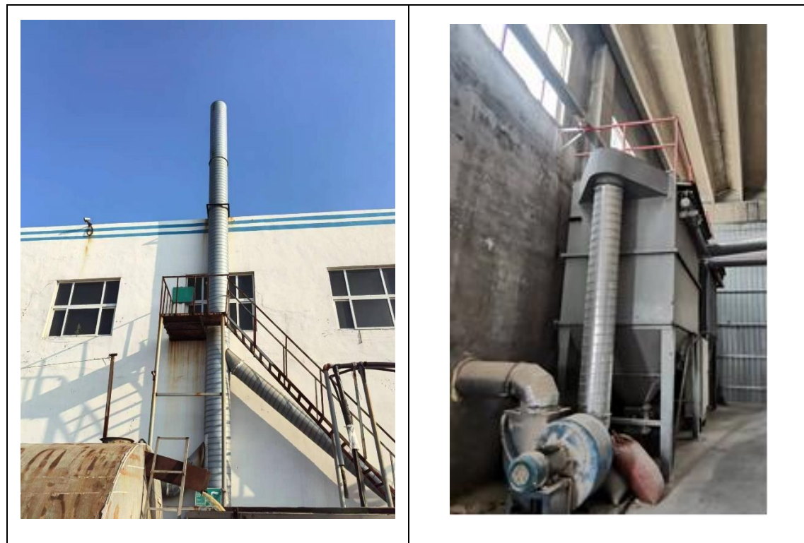
P1 排气筒废气处理设施及标识牌
